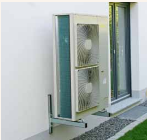
Außenanlage der Luft-/Wasser- Wärmepumpe
