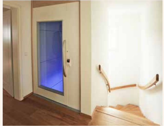
Aufzugsanlage und konvex-konkav geschwungene Handläufe
